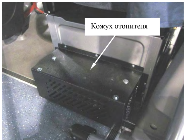
Рисунок 27. Жидкостный отопитель на тумбе одностороннего пассажирского сиденья в кабине автобуса сзади.
