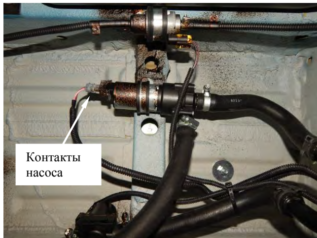
Рисунок 33. Насос жидкостного отопителя (под днищем автобуса вблизи топливного бака).
